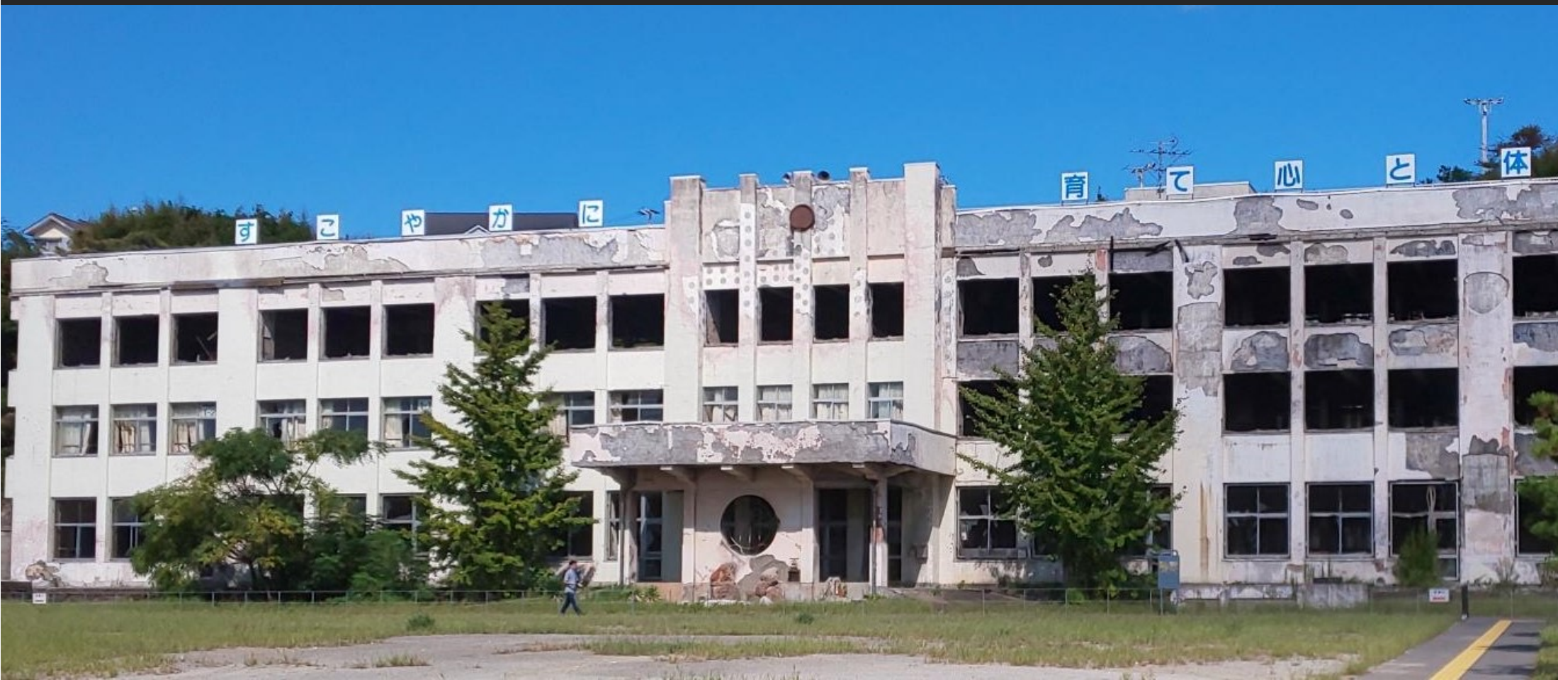
津波火災で全焼した震災遺構門脇小学校(宮城県石巻市)
